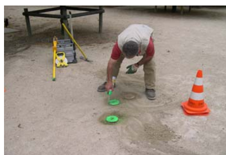
Marquage des bouches à clés
